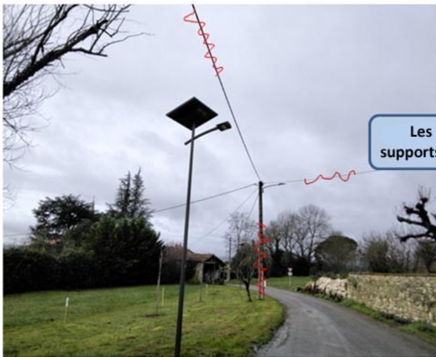
Nouveau mât solaire
